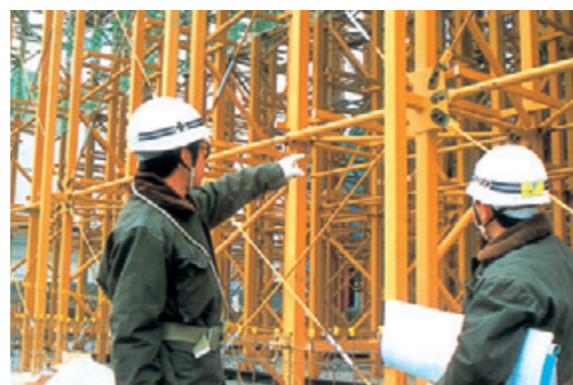
ラックビル "Rack" Building
