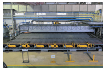
クーリングベッド Cooling Bed
